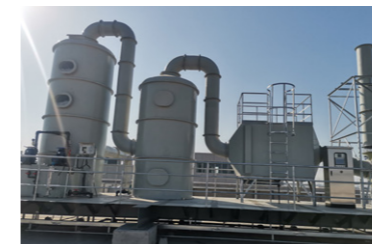
丙类危废库废气治理设施
